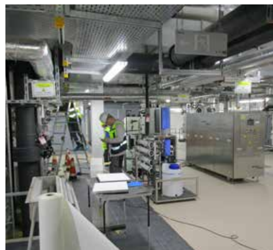
Reinräume Guangzhou China
